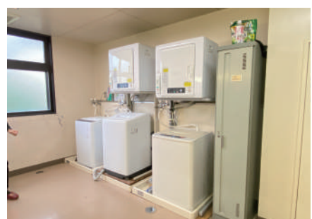
洗濯機・乾燥機
